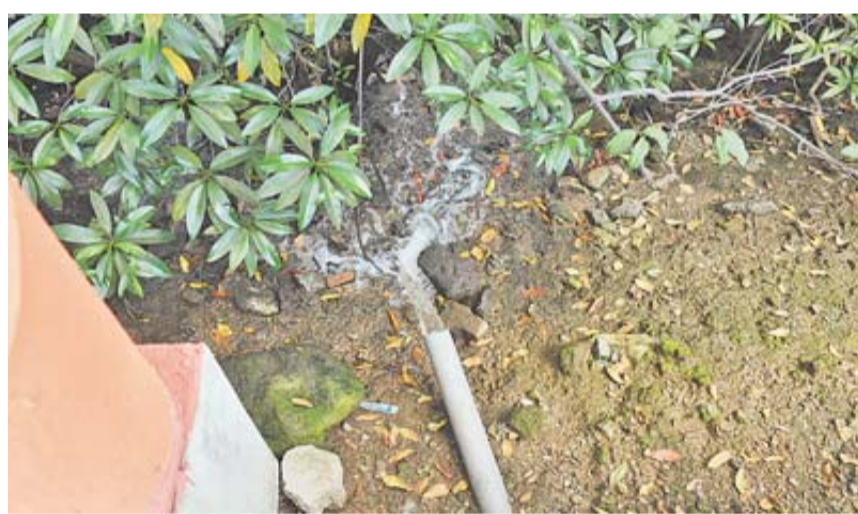
Cerca del puente 5 de Junio, hay tubos que descargan agua sin adecuado tratamiento. Además, se ven fundas llenas de basura en las orillas.
